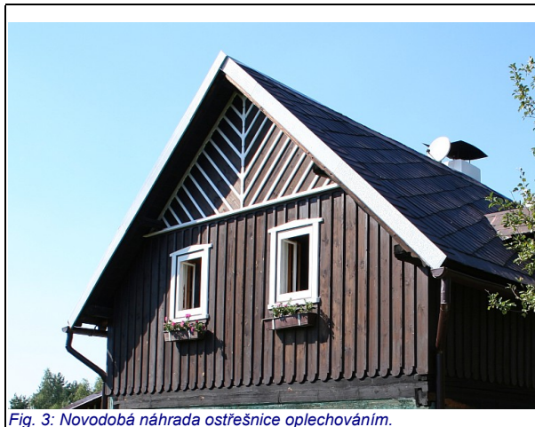
Fig. 3: Novodobá náhrada ostřešnice oplechováním.
