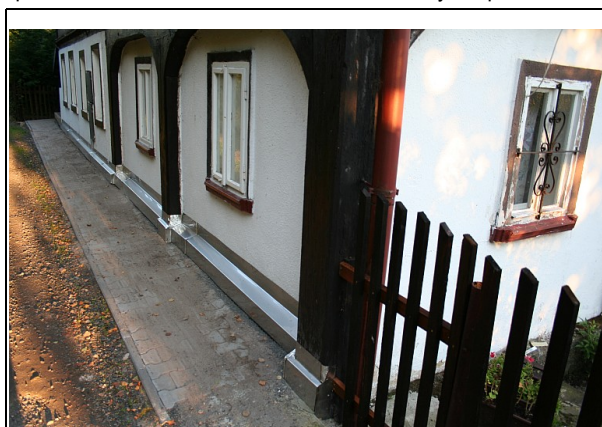
Fig. 25: Oplechování podezdívky nerezovým plechem u tradičního lidového domu - úplná absence citu pro materiál i vlastní stavbu (Mezná).
