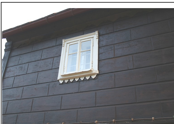
Fig. 18: Regionálně typické vodorovné bednění se svislými rýhami a klasicistně tvarovanými okny (Mezná).
